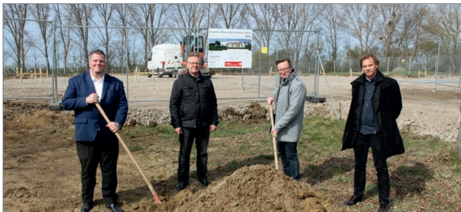
Zum symbolischen Spatenstich für den neuen Standort im Technologiepark Ostfalen trafen sich Bürgermeister Frank Nase, Sven Fricke vom Unternehmerbüro sowie die Deposerv-Geschäftsführer Jörn Plewka und Lutz Bartels (v.l.)
