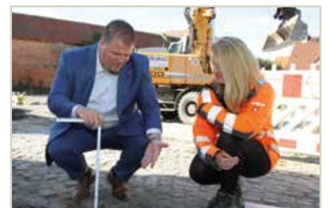
Mit der Errichtung eines öffentlichen Parkplatzes in der Schulstraße wird auch eine Oberflächenanierung der Straße durchgeführt. Bürgermeister Frank Nase nimmt mit Projektleiterin Franziska Lierse die Beschädigungen an dem Straßenpflaster in Augenschein. Foto: Thomas Zaschke
