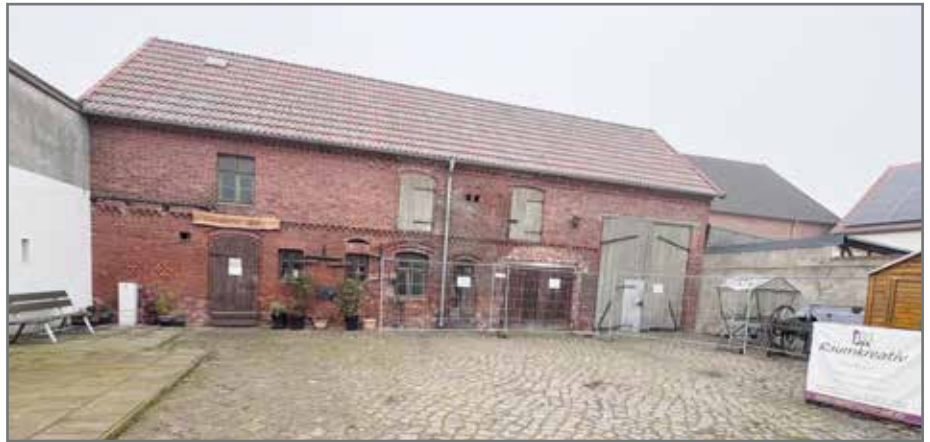
Der Ebendorfer Mühlenhof: Links ist der Eingang zur historischen Motormühle. Die Scheune rechts musste wegen Einsturzgefahr abgesperrt werden. Fotos: Thomas Pfundtner
